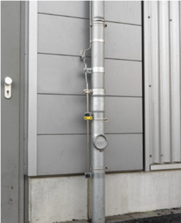
Blitzschutzableitung an einem Regenfallrohr
