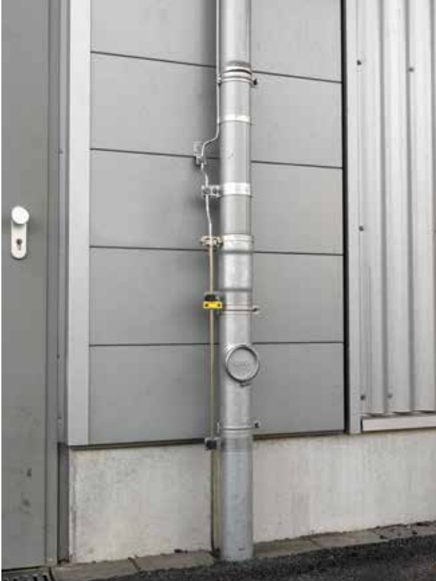
Blitzschutzableitung an einem Regenfallrohr
