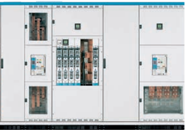
Energiehaupt- verteilung bis 4.000 A
