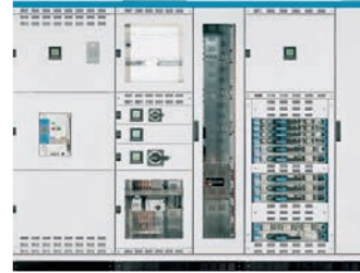
Niederspannungs- hauptverteilung NSHV
