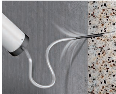
Reinigung der Bohrung Ausblasen der Bohrung zur Reinigung mit Handausbläser oder Druckluft.
