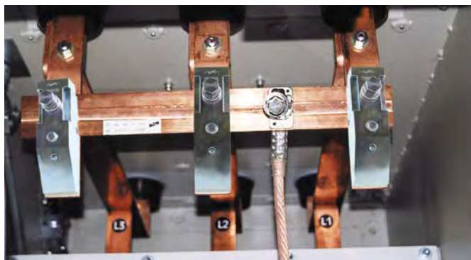
KurzschlieÙschiene mit Erdungsseil an einer Schaltanlage.
