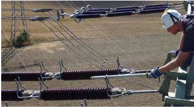
Hochspannungsanzeiger an einer 110 kV-Freileitung.
