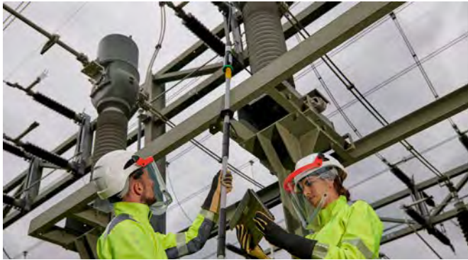
Abstands-Spannungsprüfer ASP in einer Freiluftschaltanlage.
