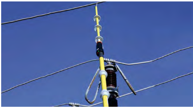
Spannungsprüfer PHE III an einer Freiluftstation 110 kV.
